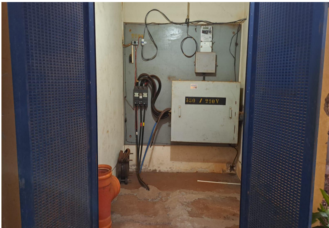
Abrigo de medição e proteção.
