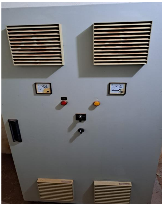
Quadro de comando
