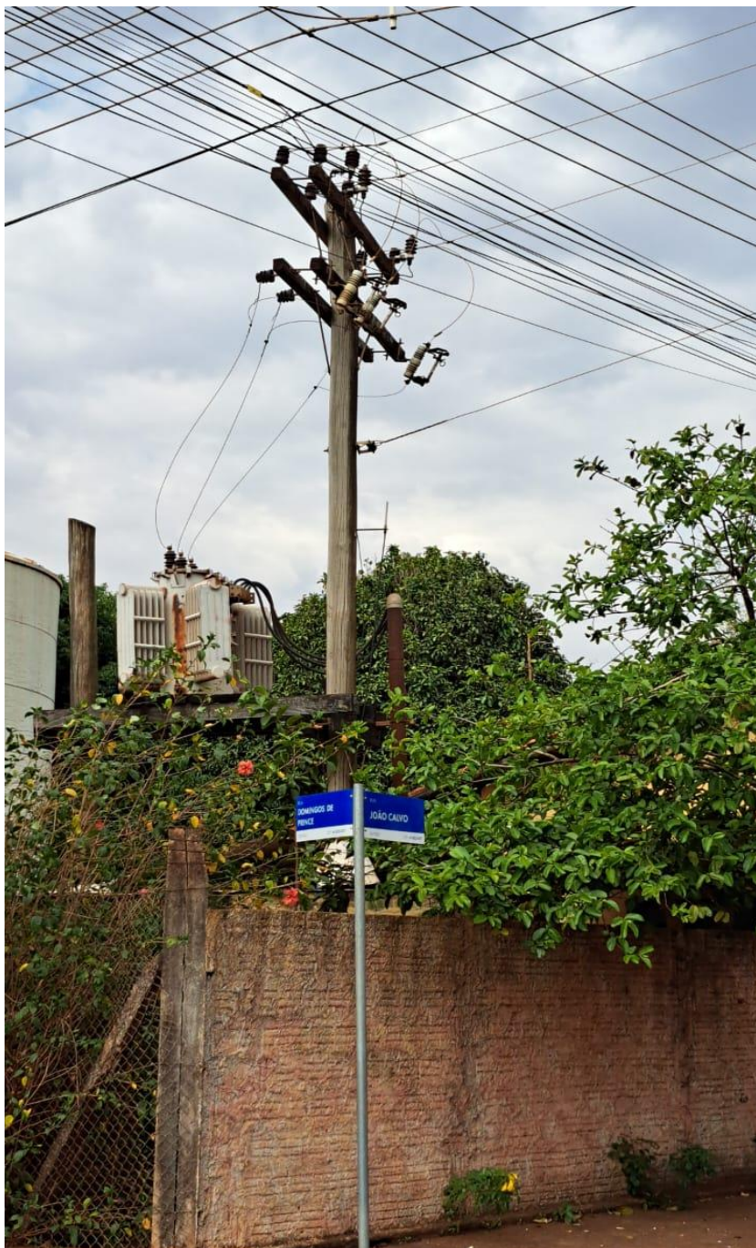
Poste de entrada aéreo transformador em plataforma
