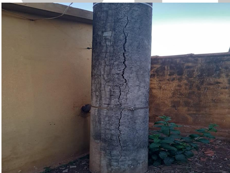
Rachaduras verificadas no poste da entrada de energia.
