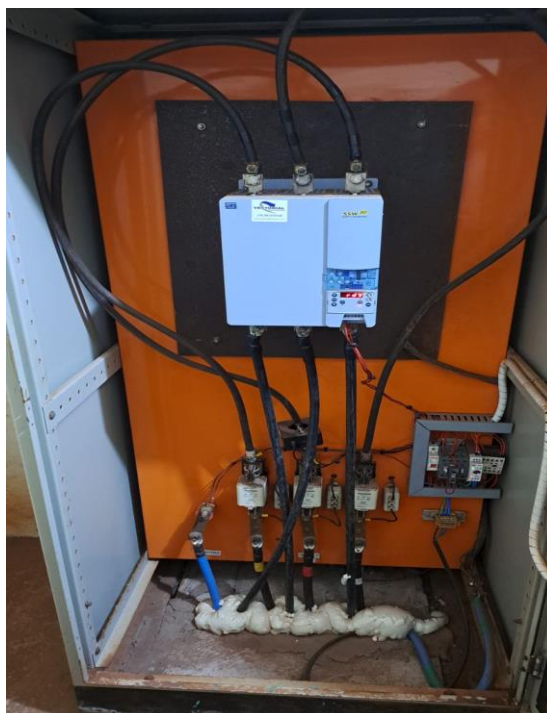
Quadro de comando – Interior
