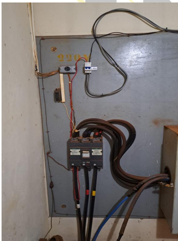
Disjuntor de proteção das instalações
