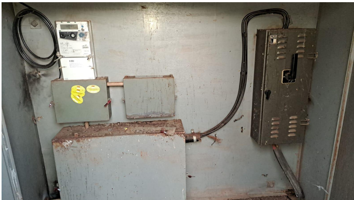
Caixa de medição e proteção das instalações medidor e seccionadora de proteção das instalações
