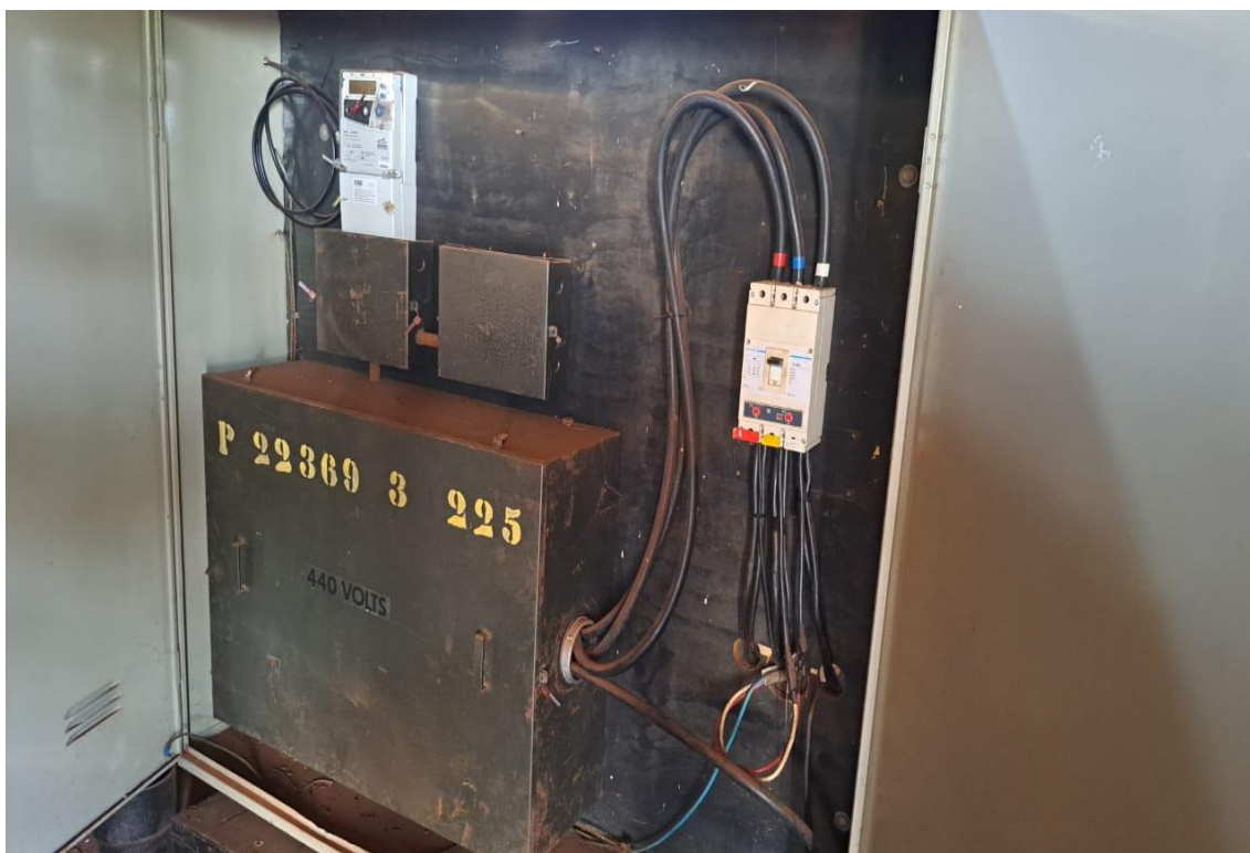
Medidor e disjuntor de proteção das instalações
