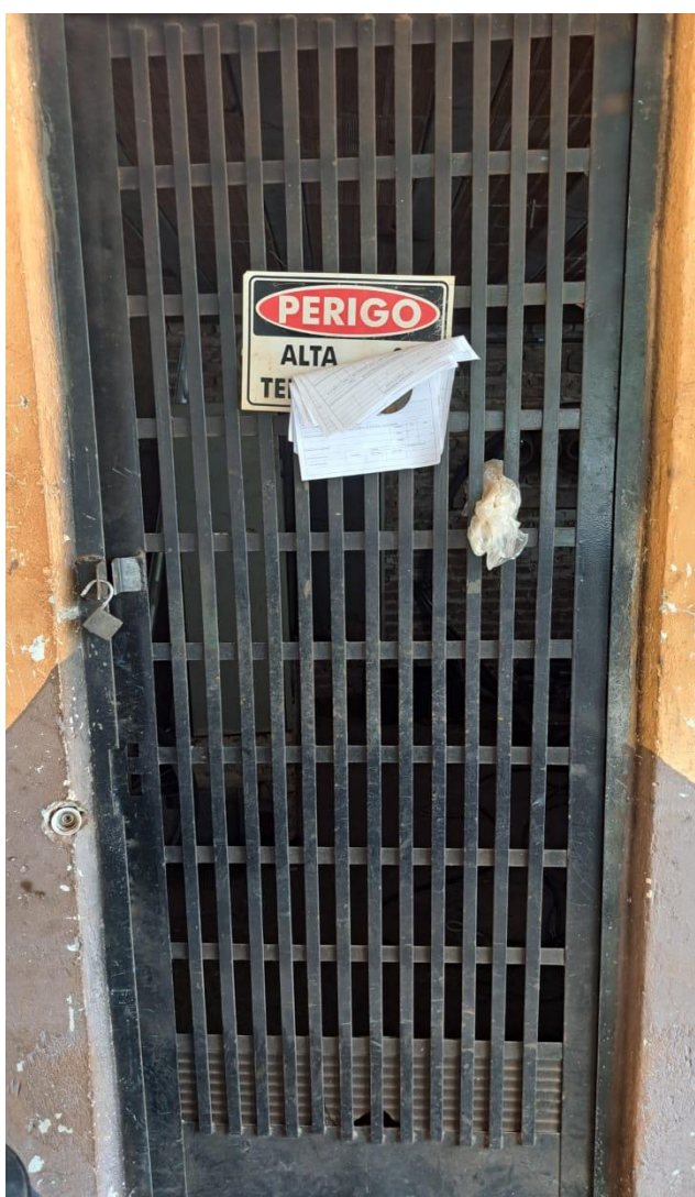
Porta de acesso ao abrigo de medição, proteção e comandos elétricos
