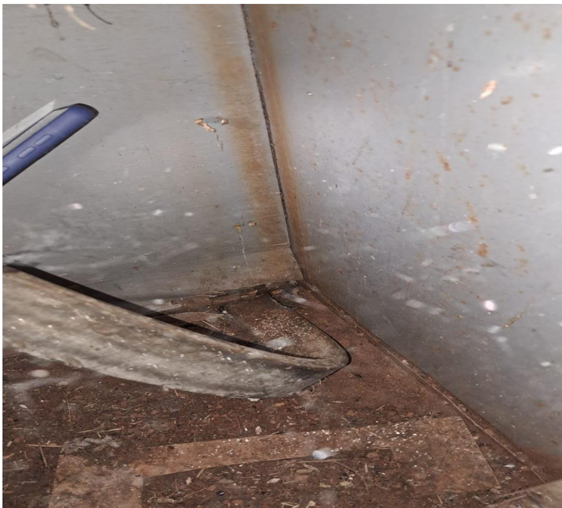
Saída do cabo do compartimento de medição e proteção para o quadro de comandos elétricos.
