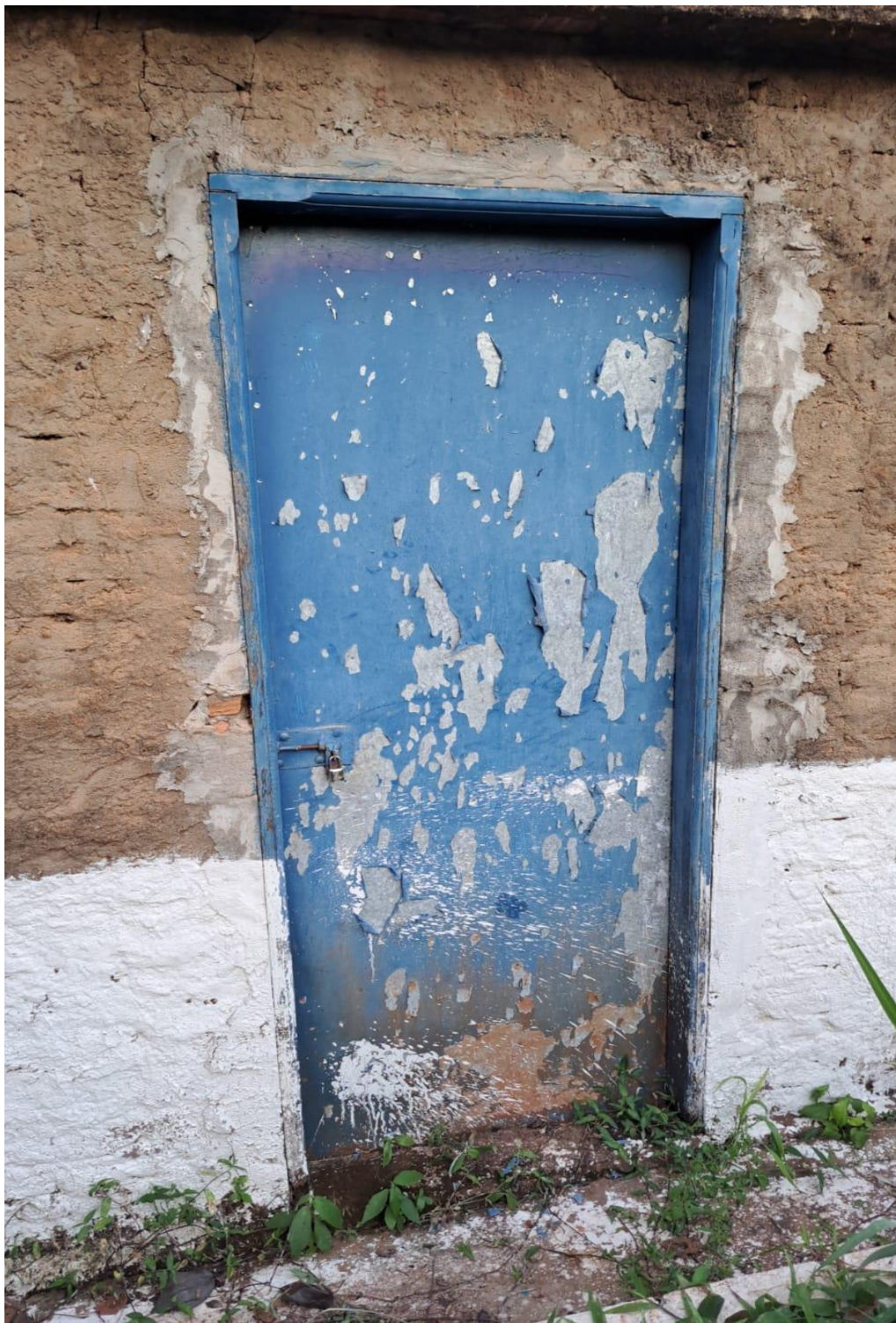
Porta de acesso ao abrigo de medição proteção e comandos elétricos
