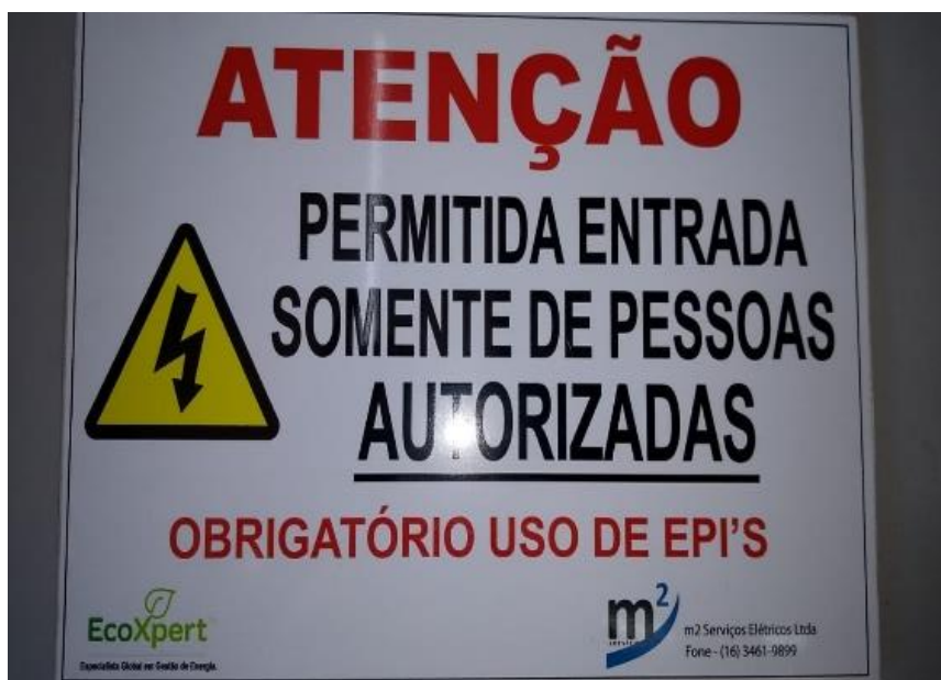
Placa de advertência
