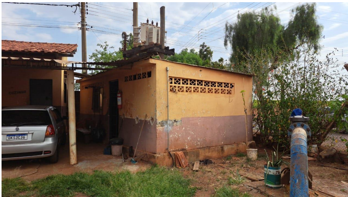
Abrigos de medição, proteção e comandos elétricos.
