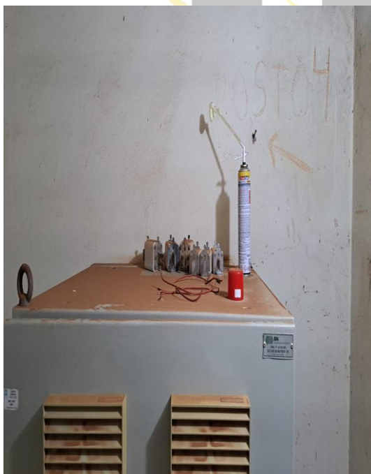
Quadro de comandos elétricos
