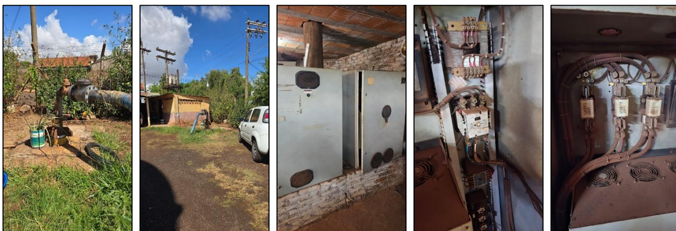
Figura 03 – Poço PMSL-P.03 durante a visita técnica da Uniper.
