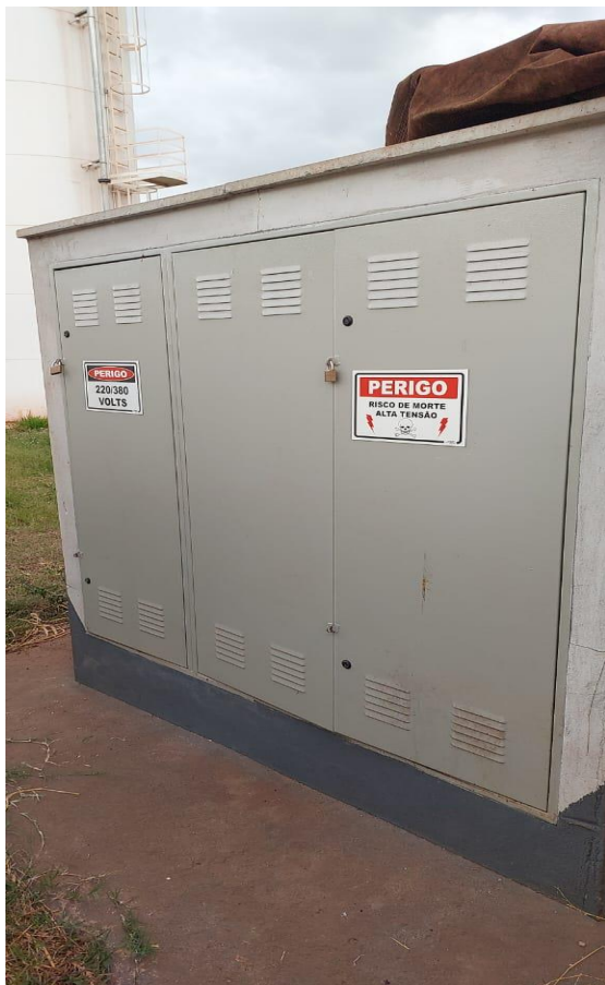
Caixa de medição e proteção
