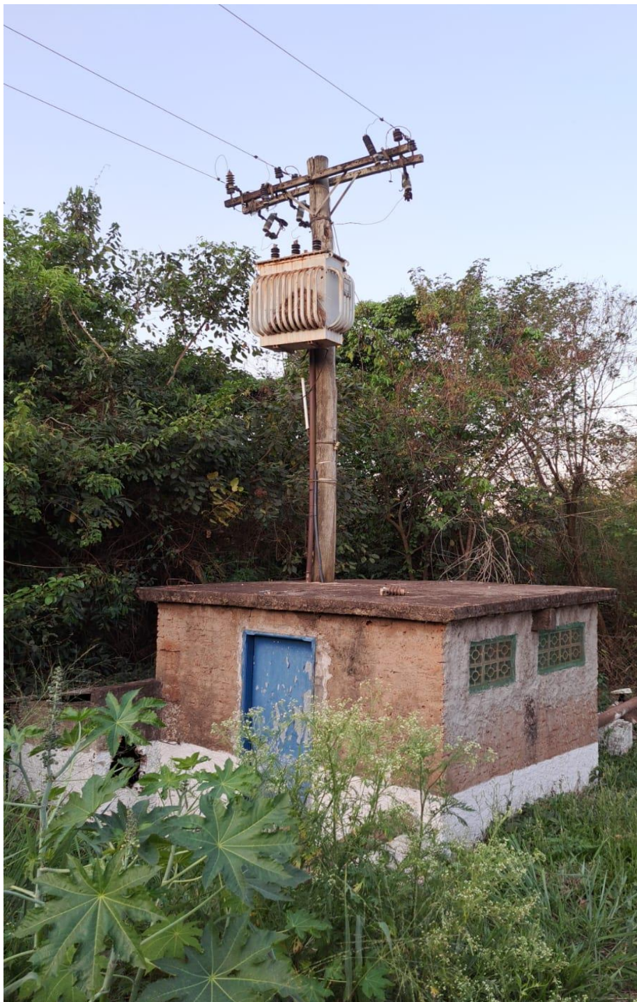
Padrão de entrada aéreo transformador ao tempo e abrigo para
