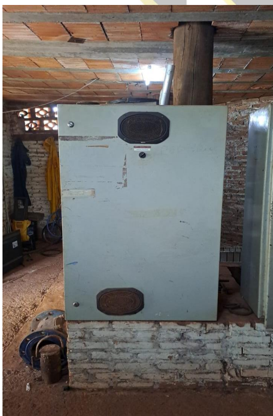
Quadro de comando da bomba de recalque
