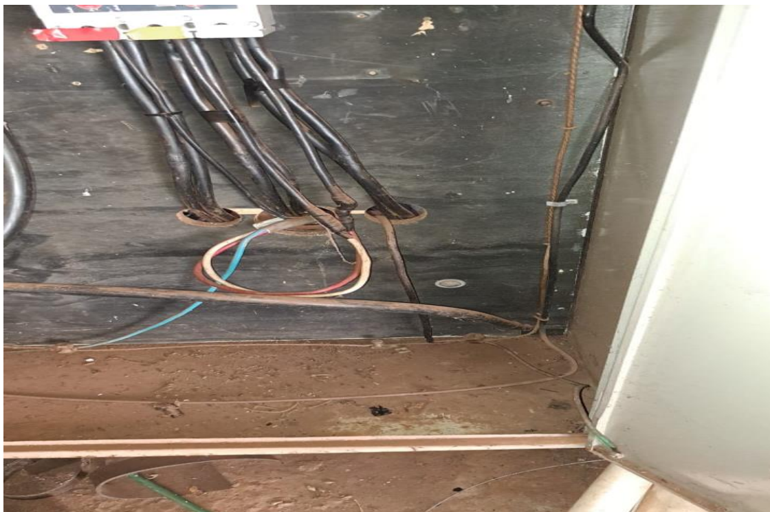
Circuitos secundários sem proteção adequada.
