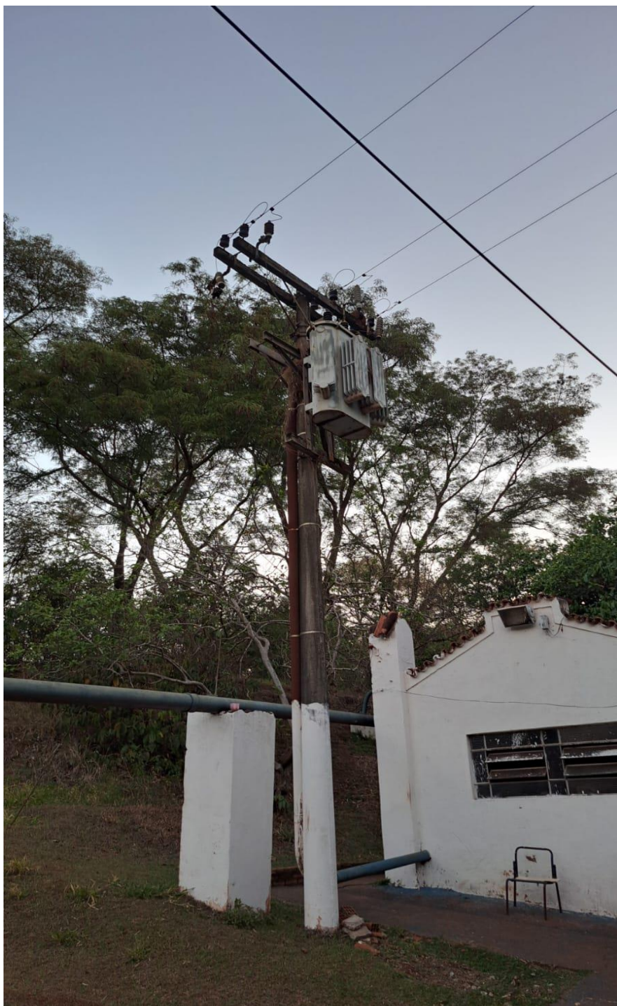
Padrão de entrada aéreo transformador ao tempo e abrigo para medição proteção e comandos elétricos.
