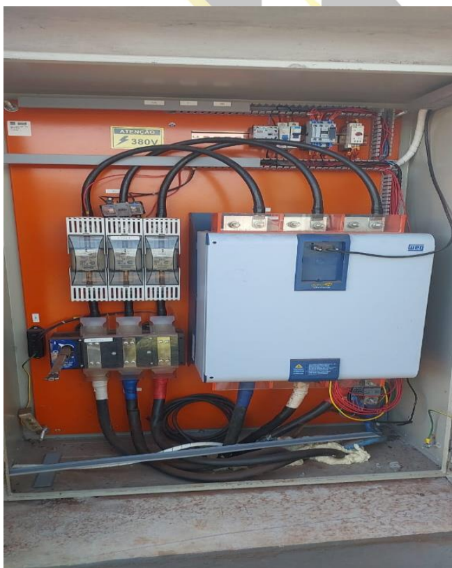
Quadro de comandos interno
