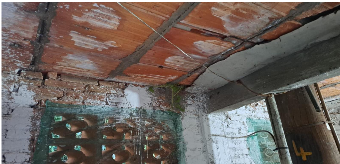
Circuitos secundários sem proteção adequada.
